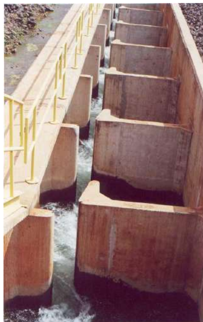
Figura 19: Escada tipo Ranhura Vertical na UHE Igarapava no rio Grande.
